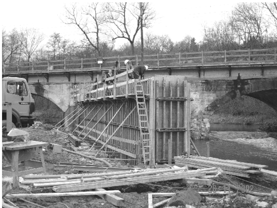
Bild 2 50% Helmtragepflicht an der gesicherten Arbeitstelle durchgesetzt, aber die allgemeine Ordnung reicht nicht aus
