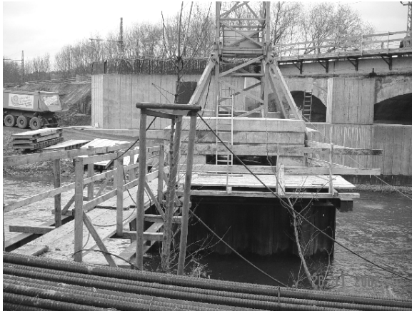
Bild 3 Ein ordnungsgemäßer Kranaufstieg ist vorhanden; den Zugang hat sich der Kranfahrer durch Material selber verbaut
