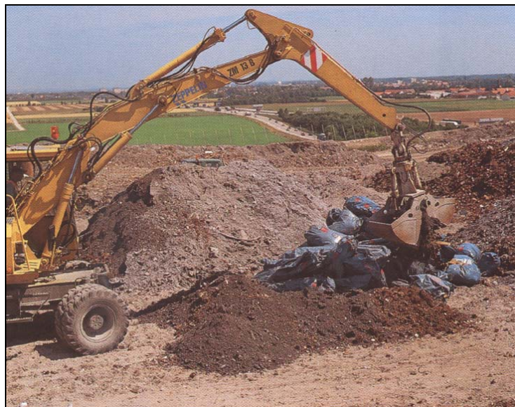
Bild 27: Deponie für die Ablagerung asbesthaltiger Fugendichtstoffe Die Entsorgungssäcke werden hier mit Schlacke abgedeckt [20]
