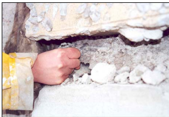
Bild 5: Fugenöffnung nach Ausstemmen
