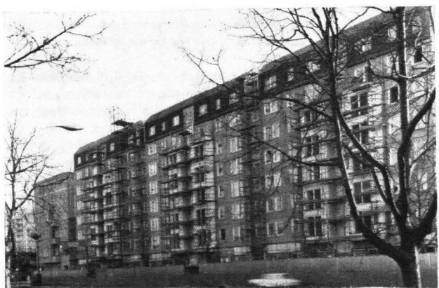
4 Berlin. Baustelle Frankfurter Allee Süd. Großplattenbau mit monolithisch ausgefülltem Keller- und Erdgeschoß (URS-Schalungssystem). 1986
