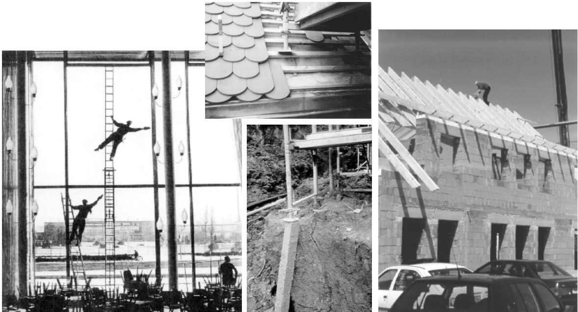
Arbeit unter Absturzgefahr (während der Errichtung und bei späteren Arbeiten), ungenügende Standsicherheit von Gerüsten
