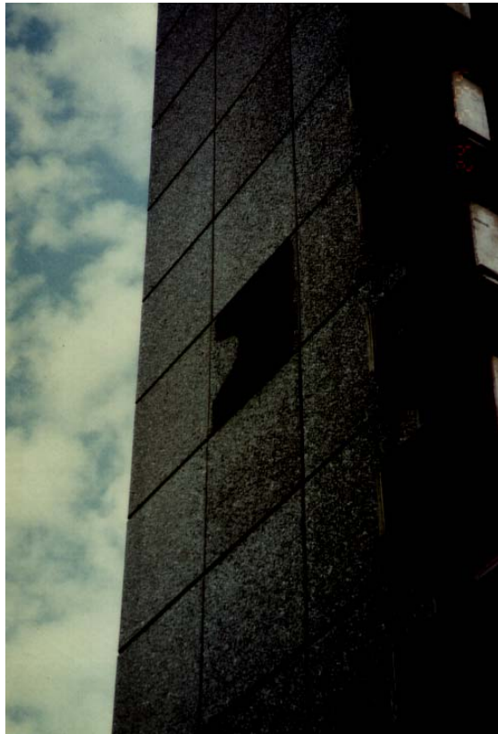
Bild 4.27 : Plötzliches Versagen der äußeren gefügedichten Betondeckschicht als Folge von in der Fertigung entstandenen Verbundfestigkeitsreduzierungen im Schadensbereich A 1
