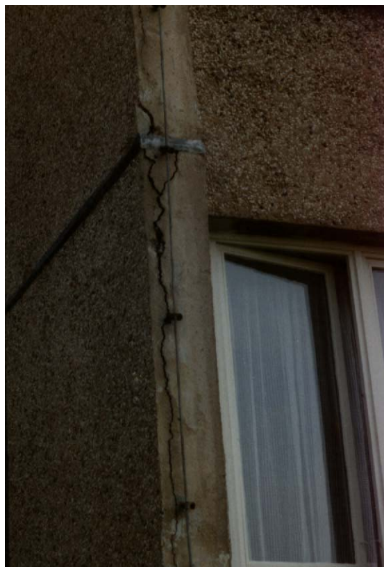
Bild 1.1 : Riß in der Ebene einer Platte aus haufwerksporigem Leichtbeton
