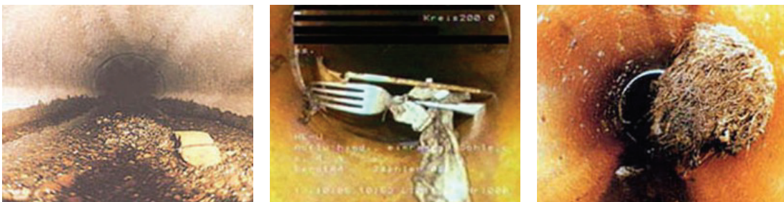
Abb. 1: Ablagerungen, Hindernisse und Wurzeleinwuchs im Kanalnetz [2]
