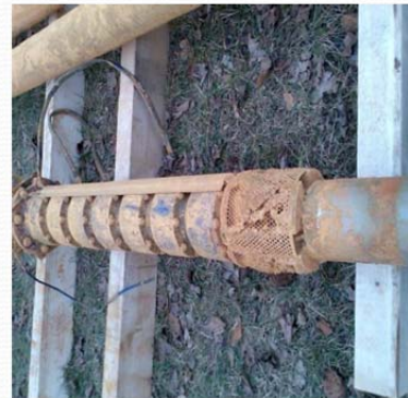
Zugesetzte Pumpe durch Ocker
