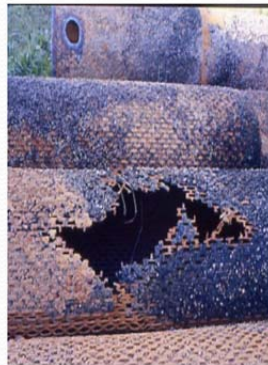
Korrosion am Brunnenausbau
