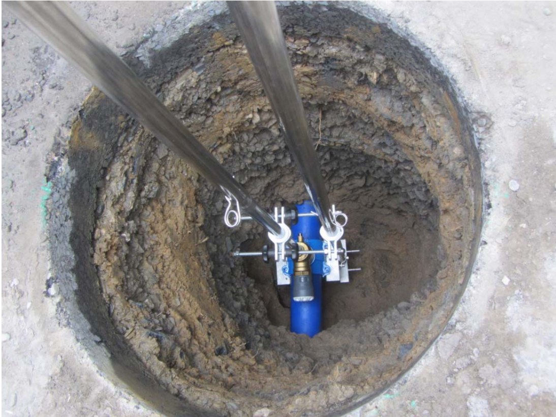
Abbildung 4: EWE-Armatur im Bohrloch
