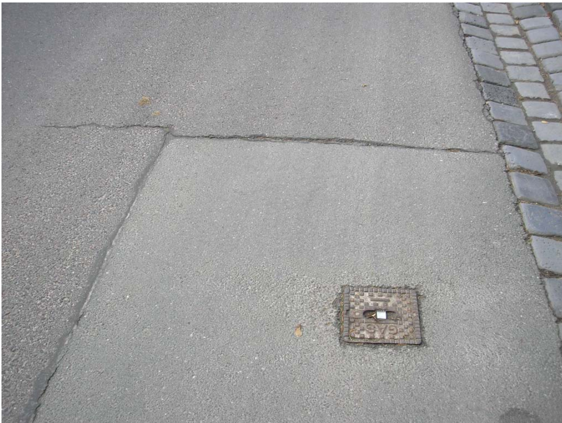
Abbildung 1: Risse in der Straßendecke
