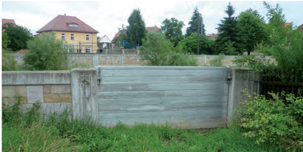
Im Hochwasserfall müssen die mobilen Hochwasserschutzsysteme aufgebaut werden, Foto: TMUEN
