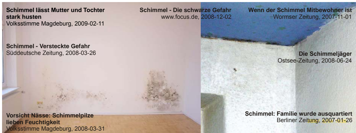
Abbildung 1.1: Zwei untersuchte Innenräume mit sichtbarem Schimmelpilzbefall und Schlagzeilen der Tagespresse. [7-13]
